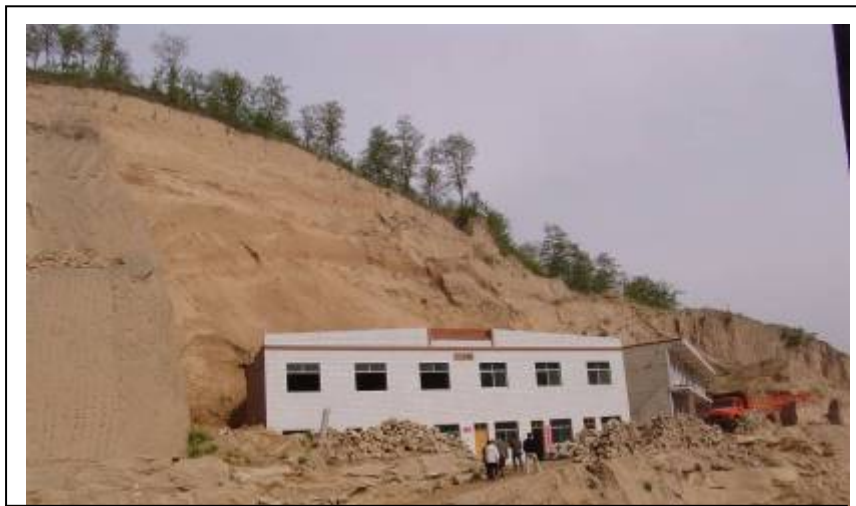
黄土土体中切坡过陡, 未进行支护, 埋下滑坡隐患(陕西延安, 2006)
