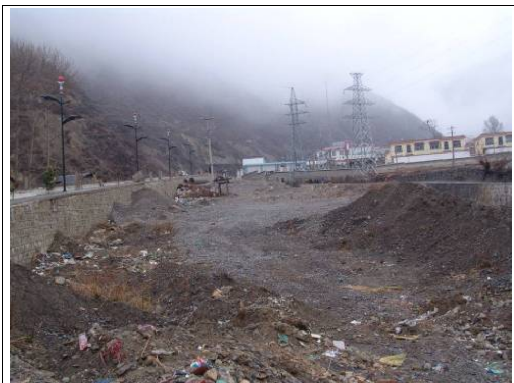
泥石流排导槽被建筑垃圾堆填，排洪能力减弱（云南德钦，2006）
